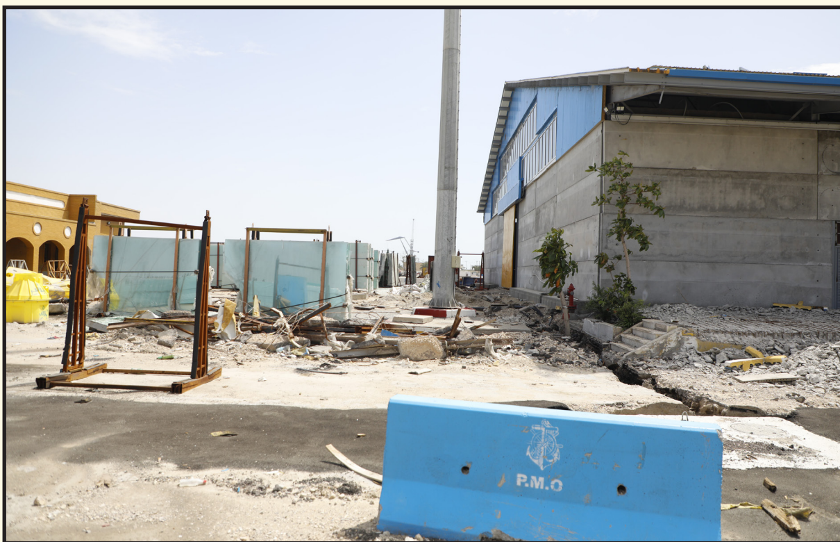
آسیب دیدن ساختمان‌ها و انبارهای بندر شهید باهنر بر اثر حملات آمریکایی - صهیونی
