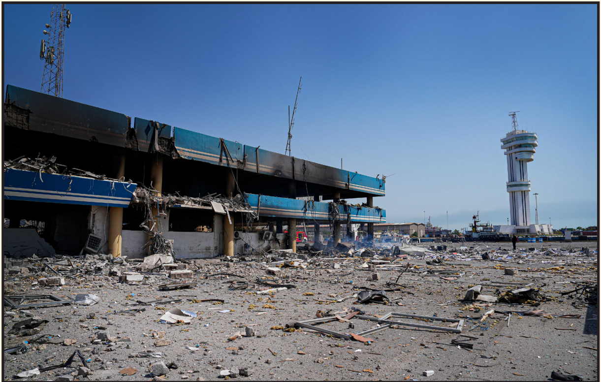
انهدام ساختمان مرجع دریایی بندر شهید رجایی در حمله جنگنده‌های آمریکایی - صهیونی
