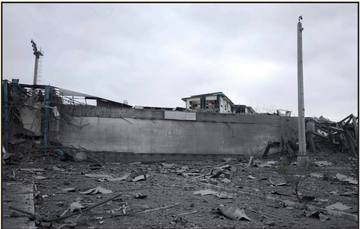
تخریب و انهدام برج کنترل ترافیک دریایی بندر چابهار بر اثر حملات نیروهای آمریکایی
